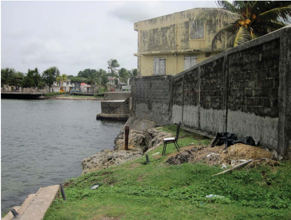
154 Le cheminement est impossible, les murs de l'habitation de la parcelle section AO n°428 étant très proche du littoral.
