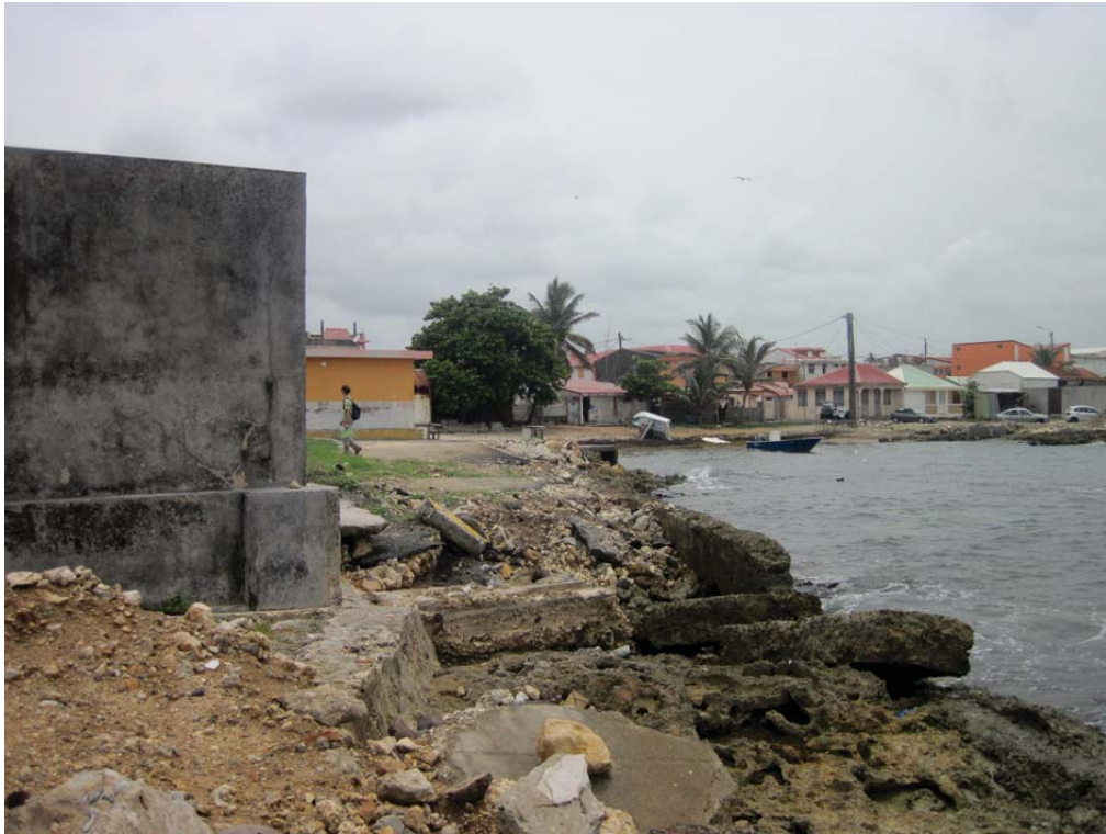
146 permettant ainsi d'éviter ce passage fortement érodé.
